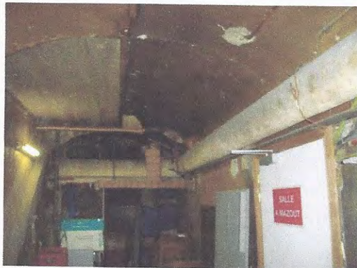
Photo 07 : dans le couloir devant la chaufferie
