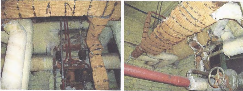
Photos 03&04: dans la chaufferie
